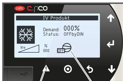
Larmåterställning Driftinformation kompressor
