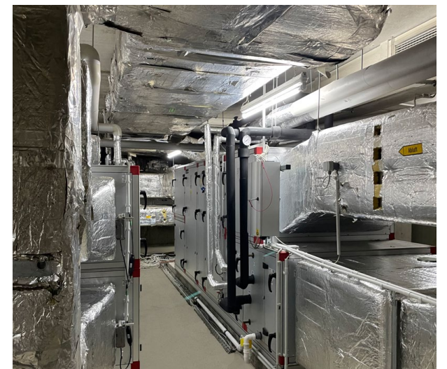
De nye ventilasjonsaggregatene på plass i det tekniske rommet på Holiday Inn.
