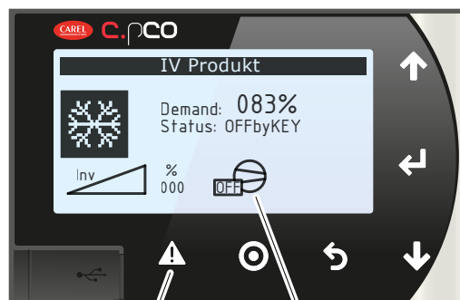
Tilbakestilling av alarm
