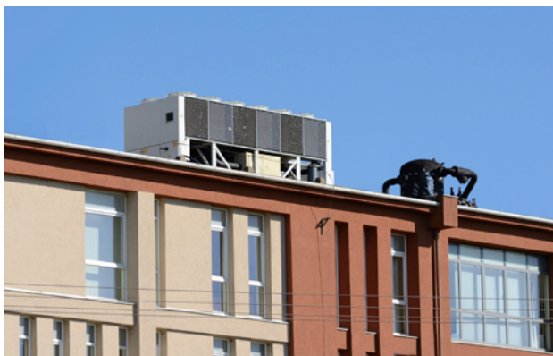
Tradycyjna instalacja na dachu.
