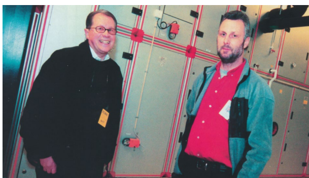
Ilmastointi oli Gekåsille tärkeää jo 90-luvulla. Tässä Nils Perlhagen ja silloinen rakennus- ja kiinteistöpäällikkö Tommy Johansson konehuoneessa.
