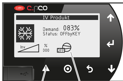
Tilbakestilling av alarm
