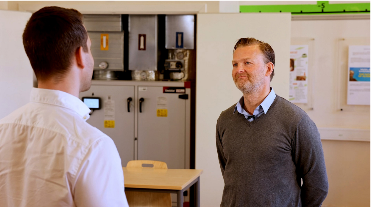
Projektleiter Krister Hansson an einem Envistar Top-Gerät in einem Klassenzimmer.
