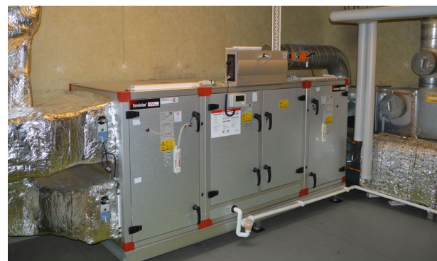
Det första ventilationsaggregatet på plats i fläktrummet.
