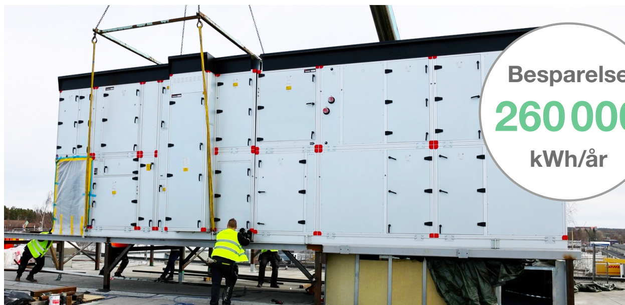
Ventilationsanlægget er et Envistar Flex i størrelse 1280. Med den integrerede kølemaskinen EcoCooler med kølegenvinding kan de klare en luftmængde på ca. 32 400 m 3 /h hver.
