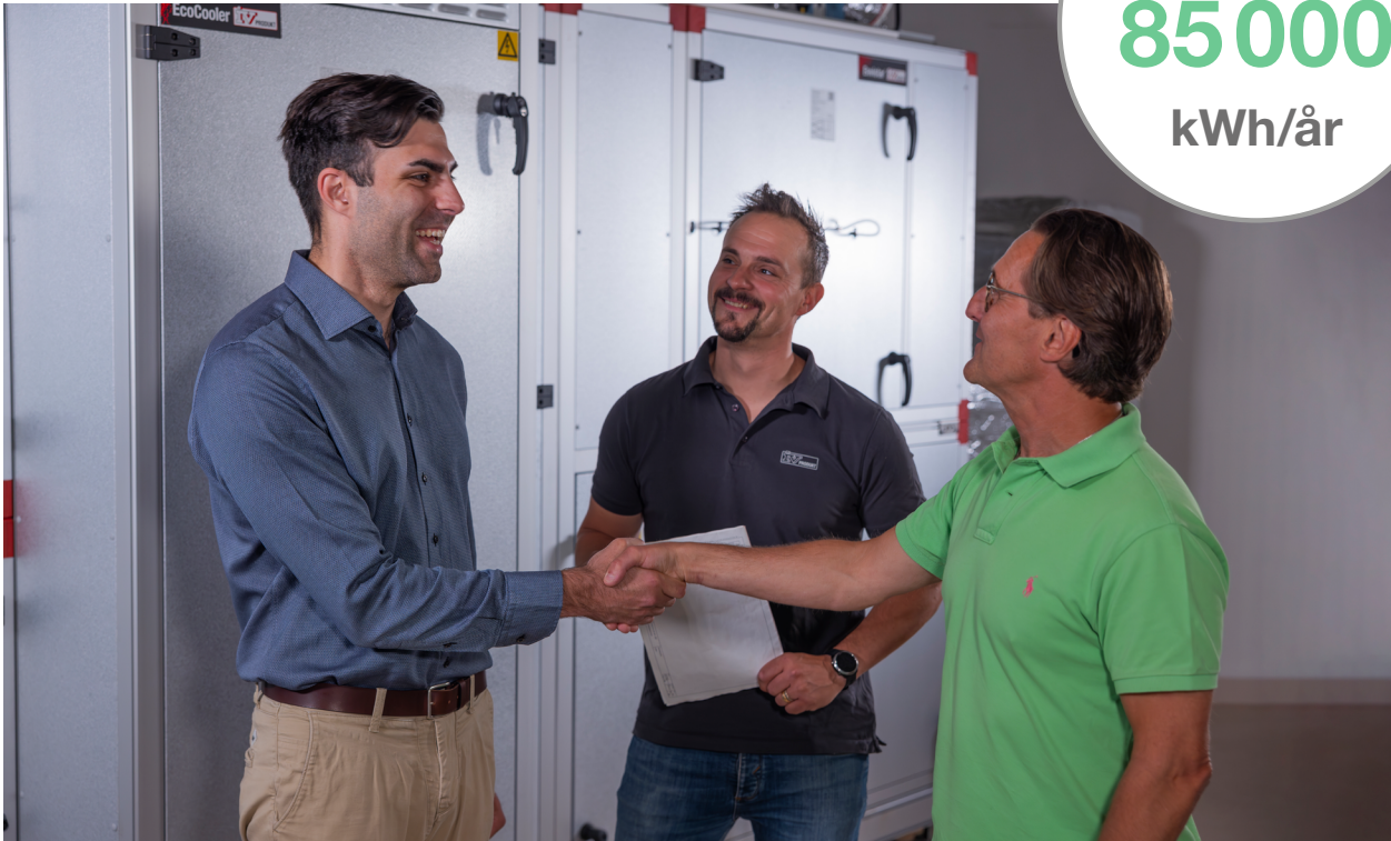
Ejendommens ejer, installatøren og IV Produkts salgsrepræsentant ved det nye anlæg. På grund af den høje varmegenvinding blev tilskudsvarmen fra fjernvarme sænket med ca. 80 %. Elforbruget til ventilatorerne faldt med ca. 50 %.
