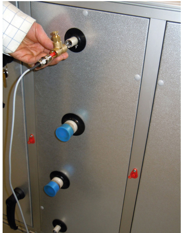
Dyktempgivare med luftningsnippel placering, tilluft vänster
