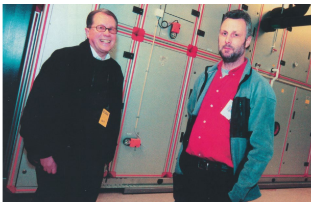
Allerede i 1990'erne var indeklimaet vigtigt i Gekås. Nils Perlhagen ses her i et teknikrum med daværende bygge- og ejendomschef Tommy Johansson.
