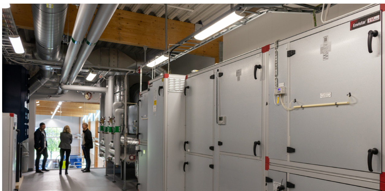
Fläktrummet på EPIC har panoramautsikt över den moderna industrihallen.
