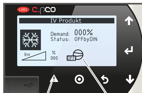
Larmåterstilling Driftsinformation kompressor
