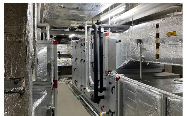
De nye aggregater i teknikrummet på Holiday Inn.
