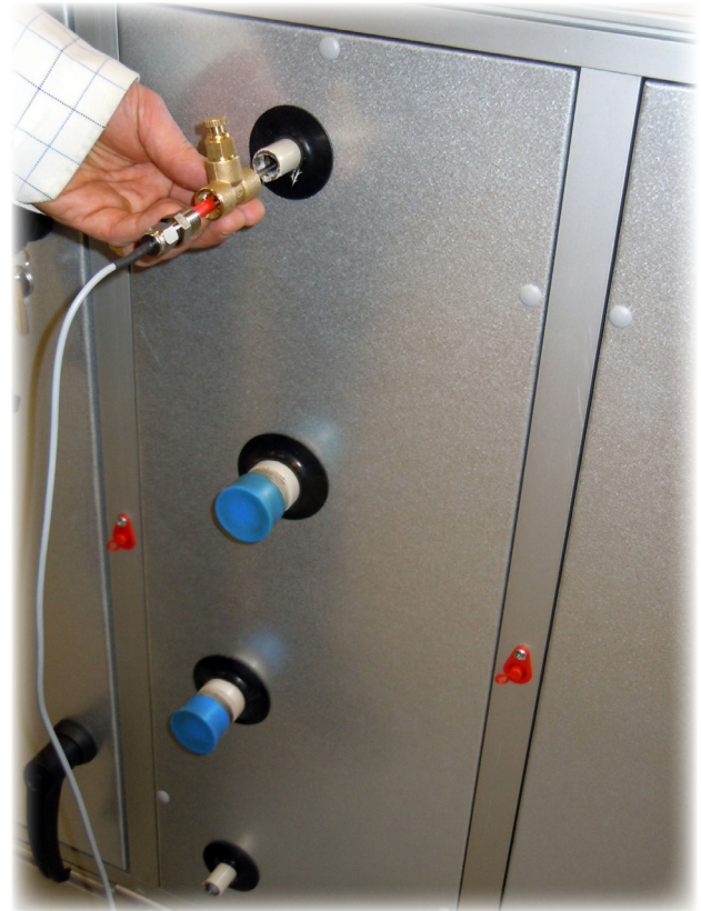
Dyktempgivare med luftningsnippel placering, tilluft vänster
