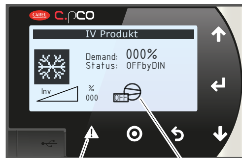
Larmåterställning Driftinformation kompressor
