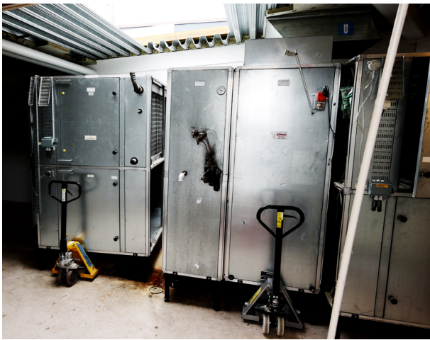
Aggregatet från 1991 hade en värmeåtervinningsgrad på cirka 40 %. Fläktarna hade ett SFP-tal på 3 kW/m³/s.
