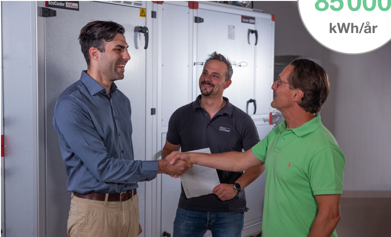
Eieren, installatøren og IV Produkts selger ved det nye aggregatet. Den høye varmegjenvinningen gjør at tilleggsvarmen fra fjernvarme ble redusert med cirka 80 %. Strømforbruket til viftene sank med cirka 50 %.
