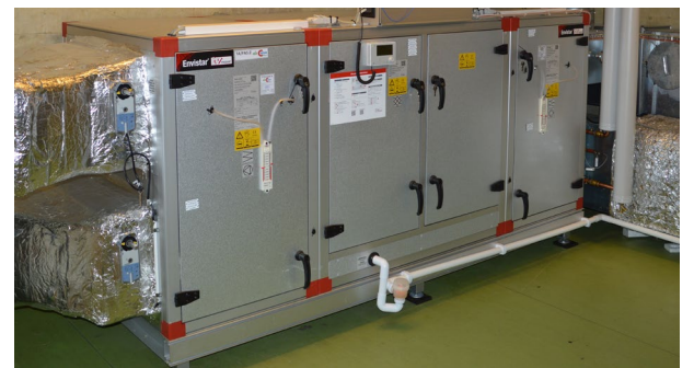
Konehuoneessa ensimmäinen asennettu kone.
