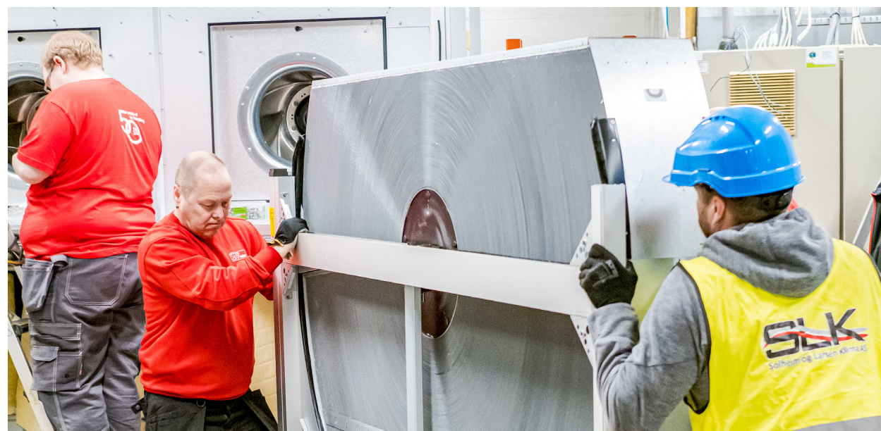
Medarbeidere fra IV Produkt og Solheim og Larsen Klima AS samarbeider om å transportere inn den delte roterende varmeveksleren.
