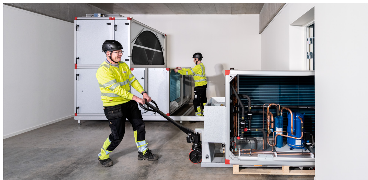
Pär og Ola fra IV Produkt transporterer inn et Envistar Flex-aggregat i størrelsen 600 med den integrerte reversible varmepumpen ThermoCooler HP gjennom en vanlig dør.
