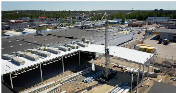
Det nyeste tilbygget gir IV Produkt 5500 nye kvadratmeter til kontorer, lager og produksjon.
